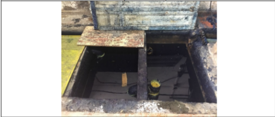
Foto No. 3. Caja de almacenamiento de ARnD.
